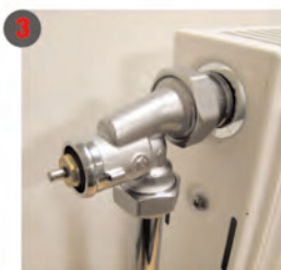
Vous apercevez maintenant le mécanisme à changer.
